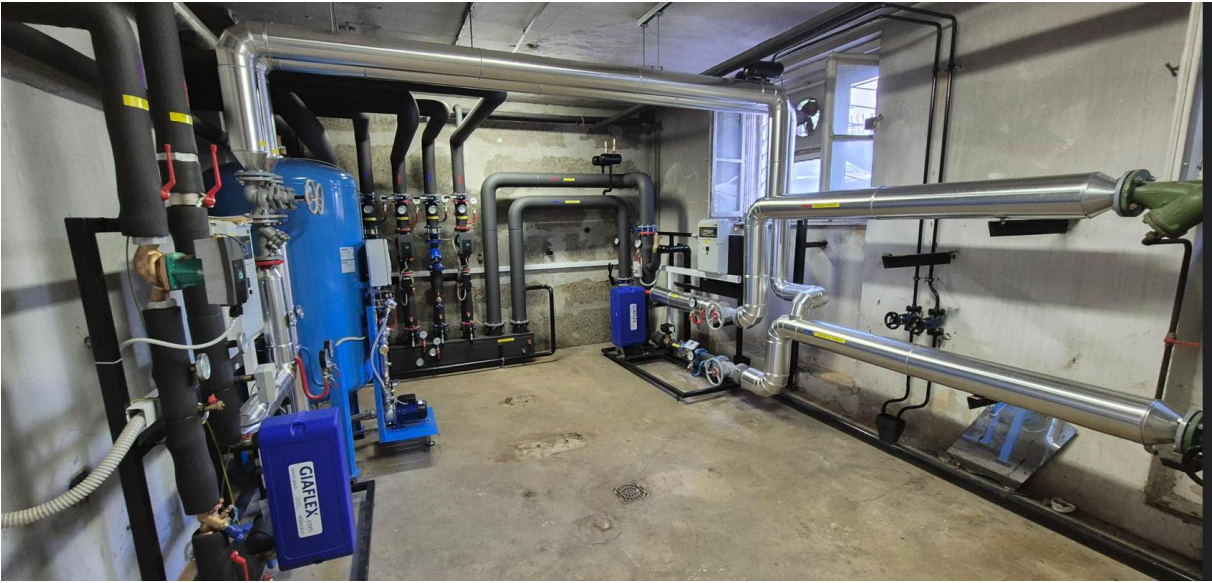
Dom AK - toplotna postaja po prenovi
