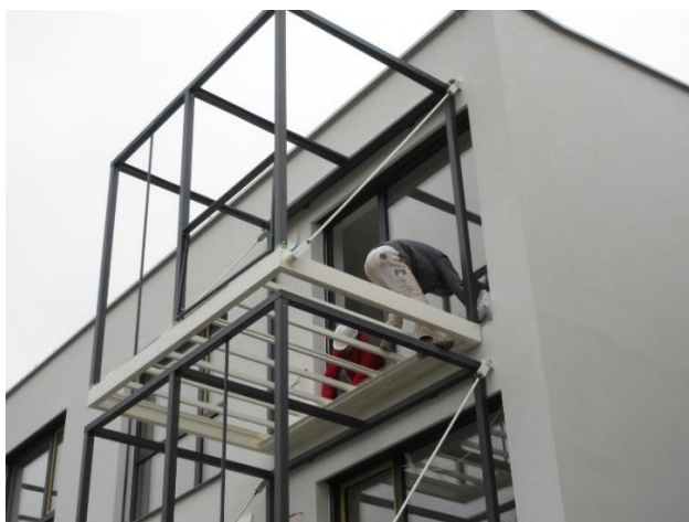
Slika 12: Nevarno izvajanje dela na višini
