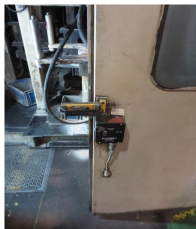
Slika 6: Odvijana – premoščena varnostna ključavnica – omogočen vstop v notranjost stroja
