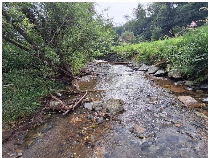
Poškodbe obrežnega zavarovanja
