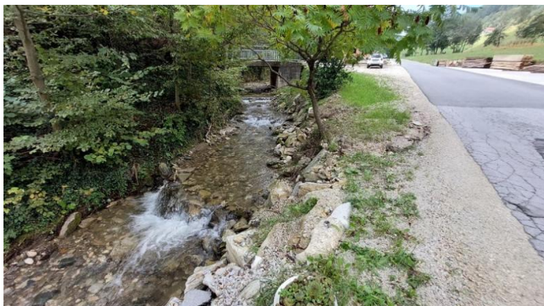
Erozija brežin in poškodbe obstoječe vodne infrastrukture
