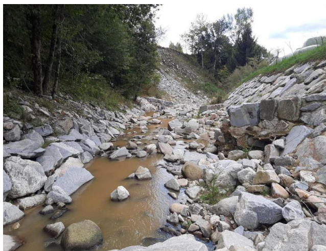
Globinska erozija, spodjedeni temelji obstoječe vodne infrastrukture
