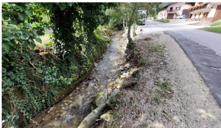
Erozija brežin in poškodbe obstoječe vodne infrastrukture
