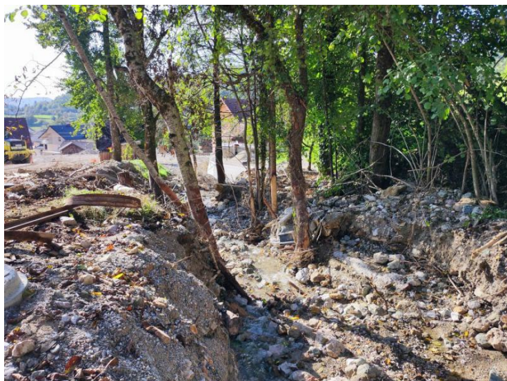
pred sanacijo in po interventnih delih
