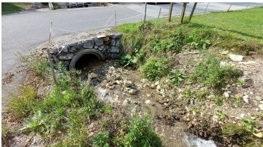
Poškodbe obstoječe vodne infrastrukture, nanosi naplavin
