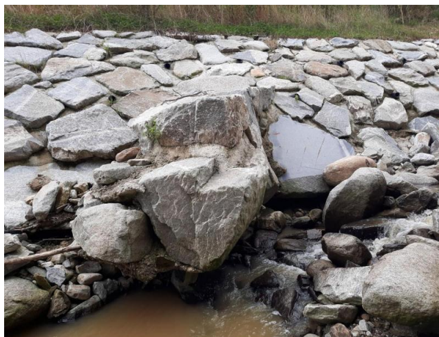
Globinska erozija, spodjedeni temelji obstoječe vodne infrastrukture
