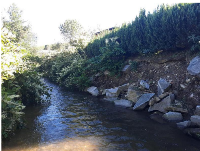
Uničeno obrežno zavarovanje na odseku ob Rimski cesti v Sl. Konjicah
