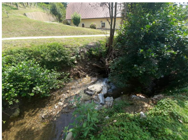
Poškodbe obstoječega zavarovanja, zajede brežin, globinska erozija
