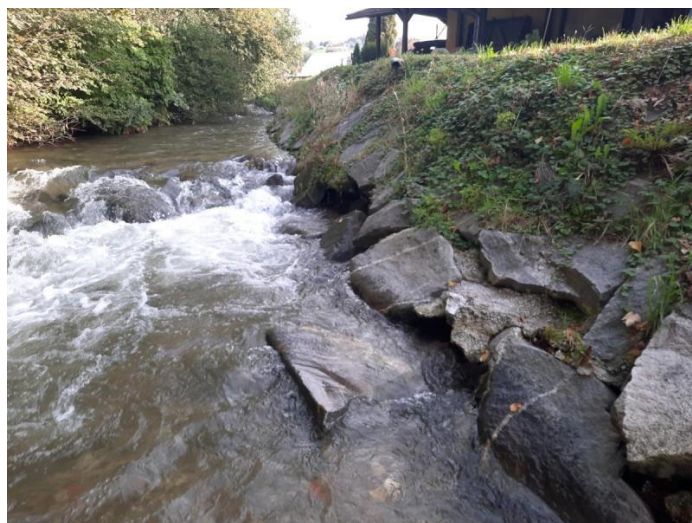
Uničeni temelji obrežnega zavarovanja v območju hiše Gabrovlje 25A
