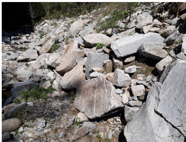
Uničeno obstoječe obrežno zavarovanje v zaledju pregrade
