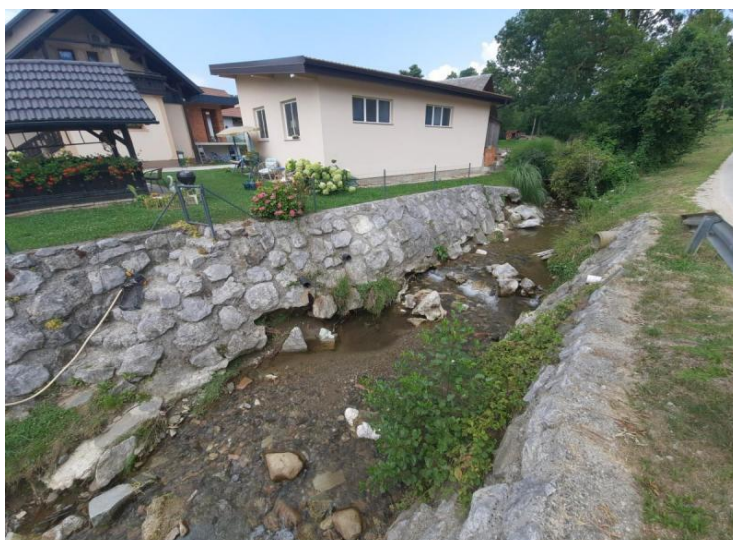
Uničeni temelji obstoječega zavarovanja, erozija dna
