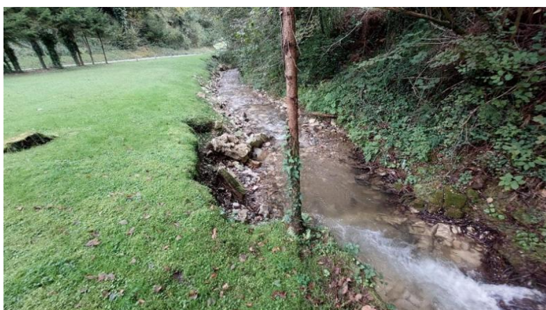
Erozija brežin in poškodbe obstoječe vodne infrastrukture
