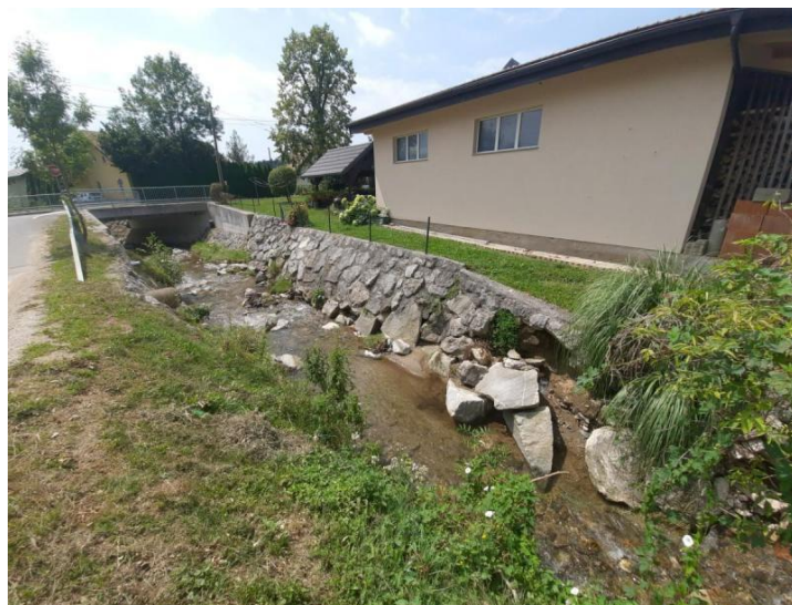
Uničeno obstoječe obrežno zavarovanje
