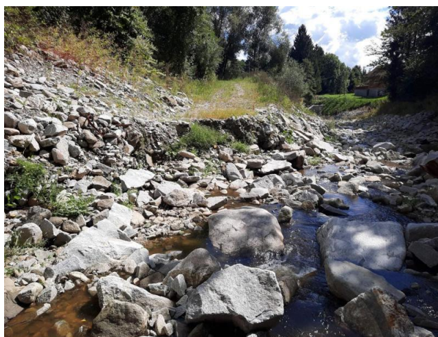
Uničeno obrežno zavarovanje in dostop do zaplavlka pregrade
